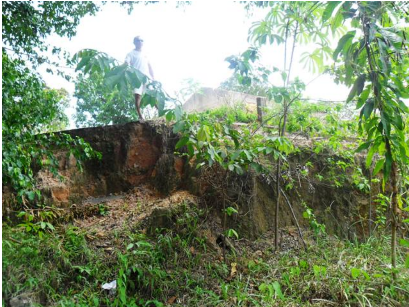
Ruptura na estrutura do terreno aterrado. Fonte: Arquivo da pesquisa 2011
